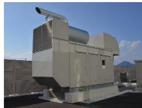
72時間対応の大型非常用発電機
