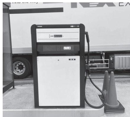
構内給油設備
